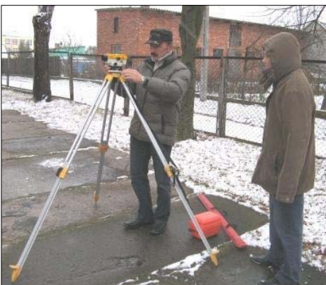
Spółecznie wykonywane przygotowanie do budowy skwerku dla uczniów w Krasnosielcu. Pomiarów dokonuje Wojciech Łączyński oraz Mirosław Chodkowski. Fot. S. Rutkowski, 24 listopada 2008r.
